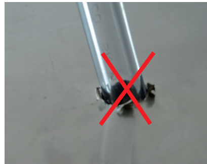
Abb. 8: Verbotene Verlegung, Bohrung ist nicht entgratet, eine Tülle o. Ä. fehlen.
